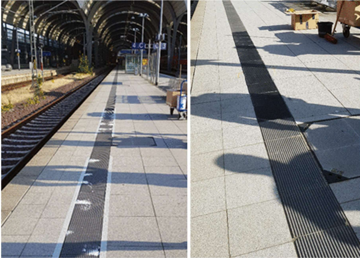
Hbf Kiel, Überklebung von Schadstellen – als Provisorium oder für dauerhaft
